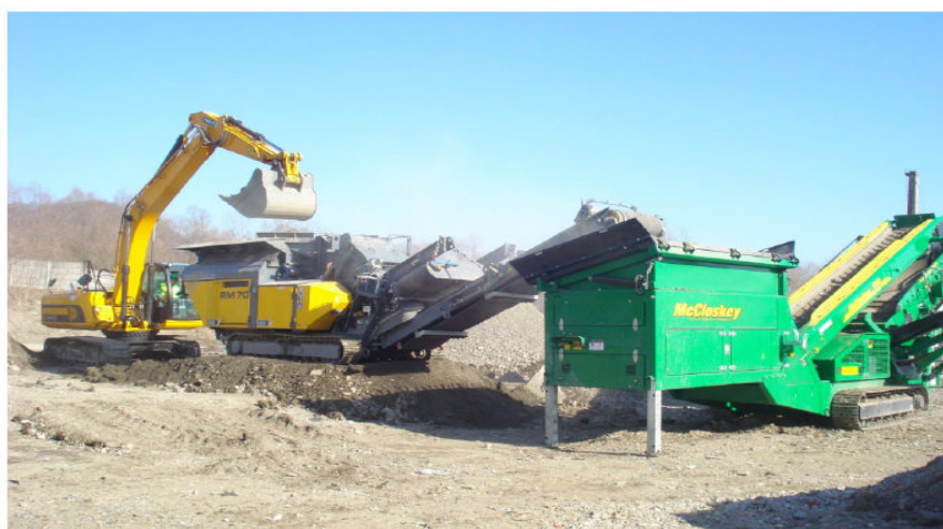
Figura 2 – 12 Stație de preluare și prelucrare a deșeurilor provenite din construcții și demolări – Medias.
