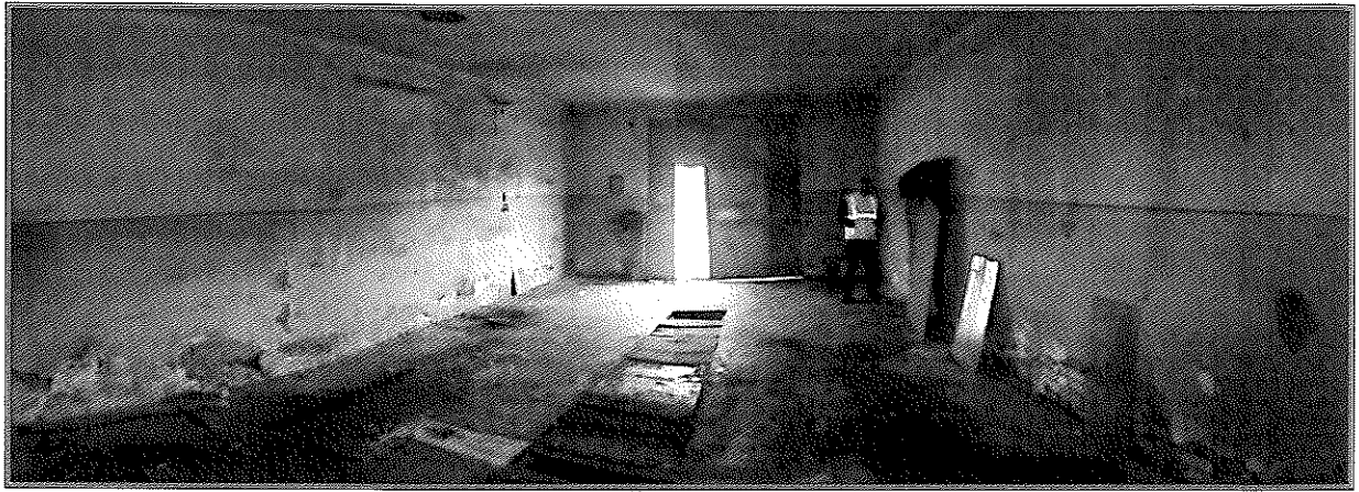
INTERIOR PAVILION O: REMIZĂ (C1): GARAJ (3) CU ȘAHT INUNDAT
