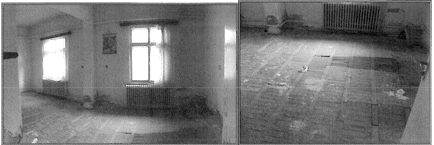
PAVILION L (C4) – ADMINISTRATIV, INTERIOARE ARIPA NORDICĂ (P): BIROURI, DETALII PAROSEALĂ PARCHET DETERIORATĂ DE UMEZEALĂ
